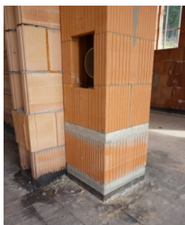
Přerušení tepelného mostu pod komínem
