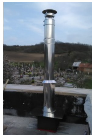
Prostup a vysoké lemování na ploché střeše
