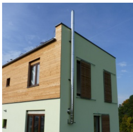
Fasádní nerezový komín na novostavbě
